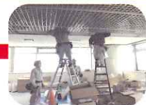
全館照明LED化へ
